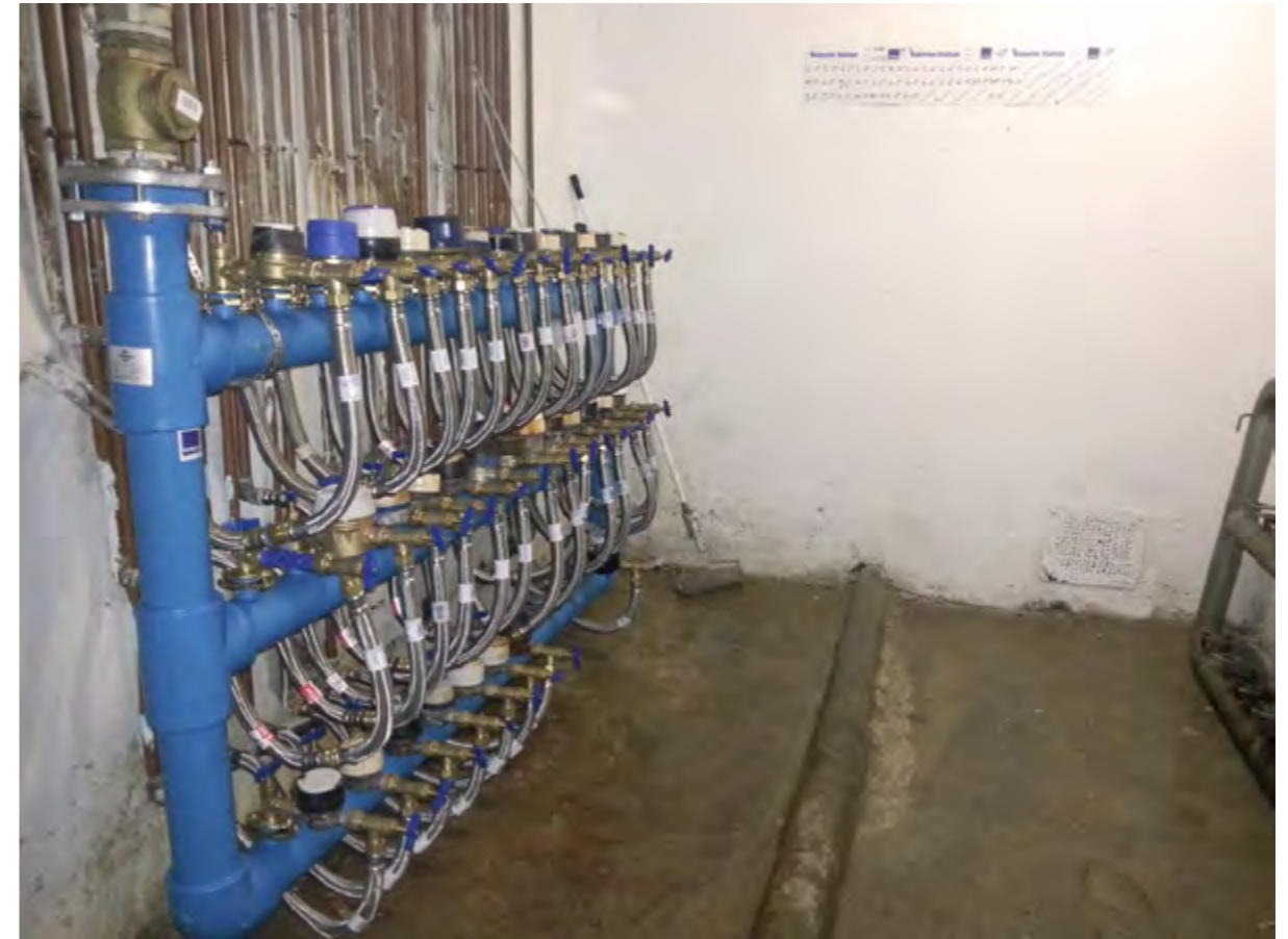
Instalaciones de agua y gas.
